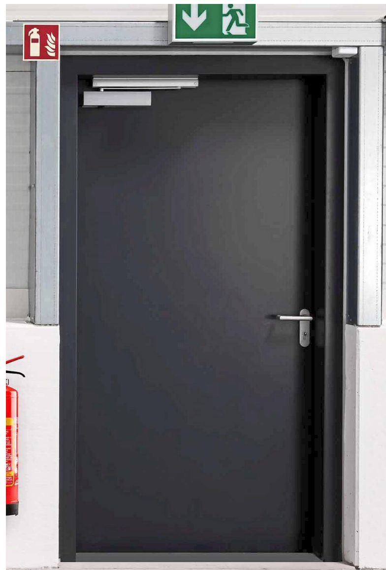
Brandschutztüren oder aber auch Brandschutztore gehören zu den Fachgebieten des Unternehmens. Foto: pr
